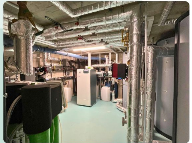
Haustechnik mit Erdwärmepumpe
