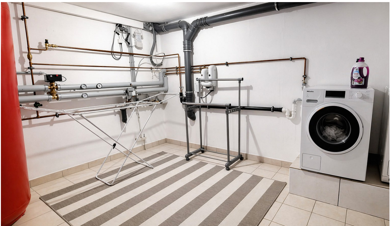
Technikraum / Waschraum Keller
