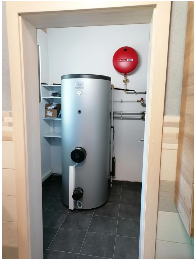
Technikraum, mit Speicherbat.
