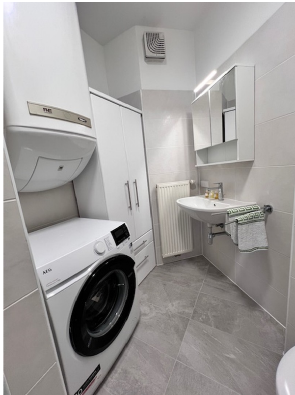
neuer Fernwärmespeicher, Alibert
