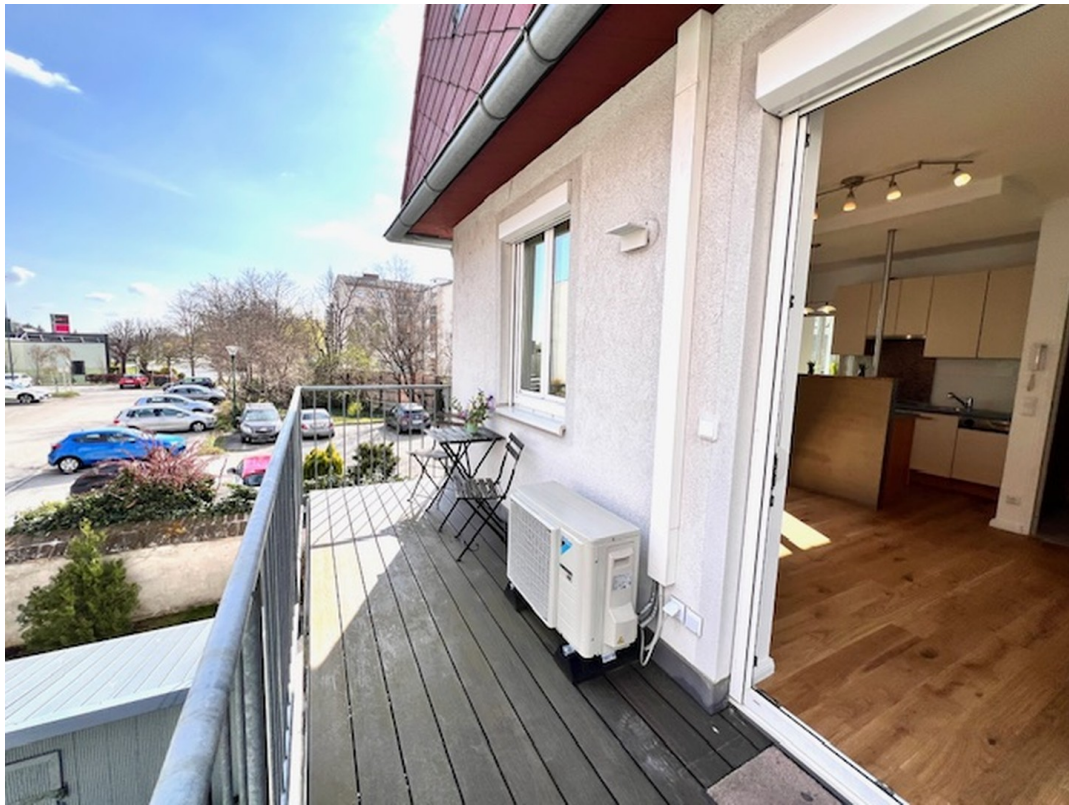
Balkon mit Klimagerät
