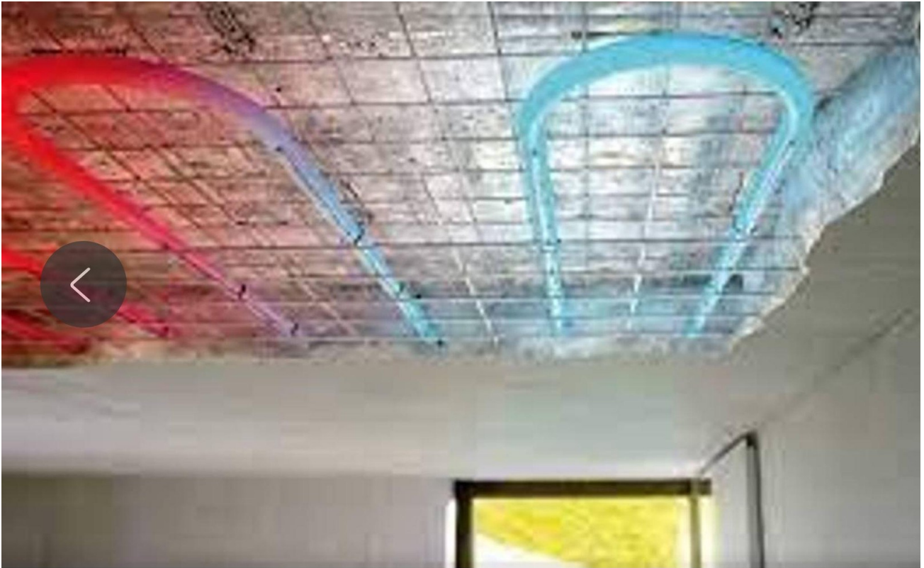
Deckenkühlung in der Decke
