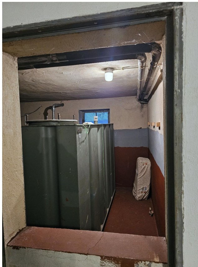
Öltankraum Keller (NO)
