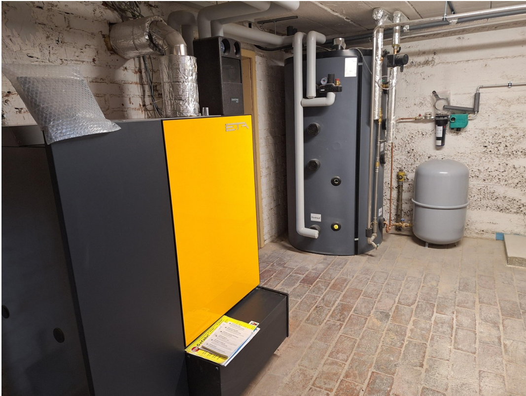
ETA Pelletheizung + WWSpeicher
